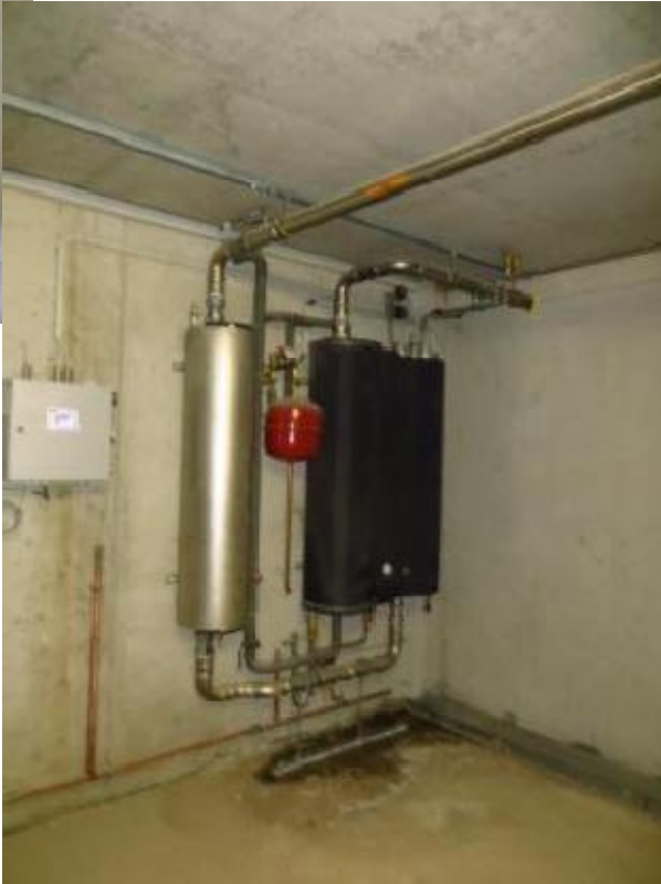
Arrivée du biogaz
