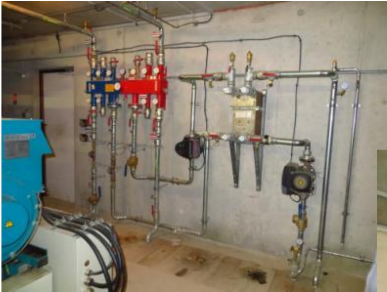
Distribution d'eau chaude depuis la cogénération
